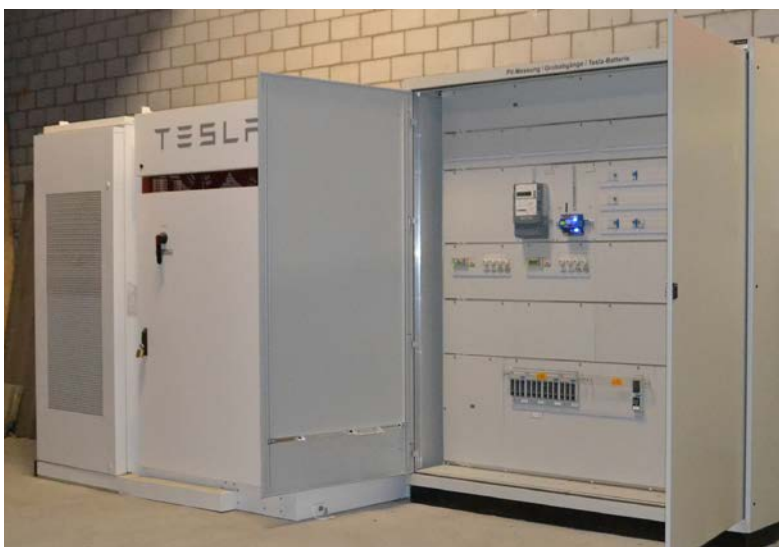
Der KMU-Speicher der Allenbach Holzbau und Solartechnik in Frutigen. Im Vordergrund Schaltung und Steuerung, im Hintergrund das Tesla Powerpack.
